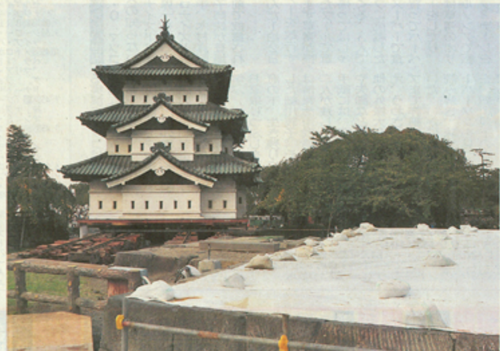
曳屋ウィーク2日目終了後の弘前城天守。油圧ジャッキで動かした分も含め、天守台(右手前)からの移動距離は約35mとなった
